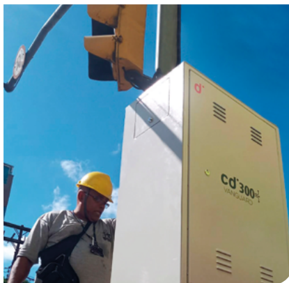
Instalação do Controlador CD300 Vanguard em Porto Alegre RS
